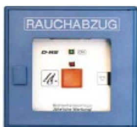
Commande manuelle au niveau accès pompiers
