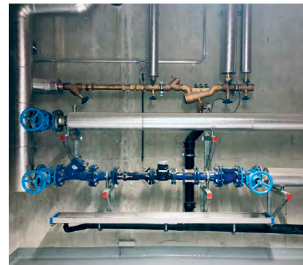
Poste de mesure de type industriel à bride.
