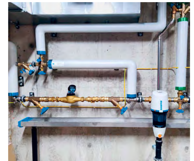
Poste de mesure domestique à visser.
