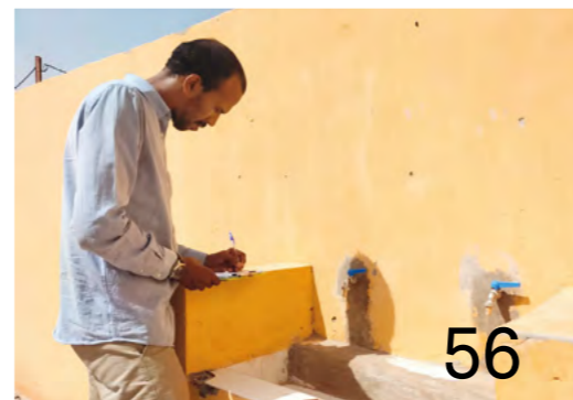
Réparation des robinets dans l'école Jemal Hassane. Travail suivi par l'ingénieur Bouna Sidi Boune.
